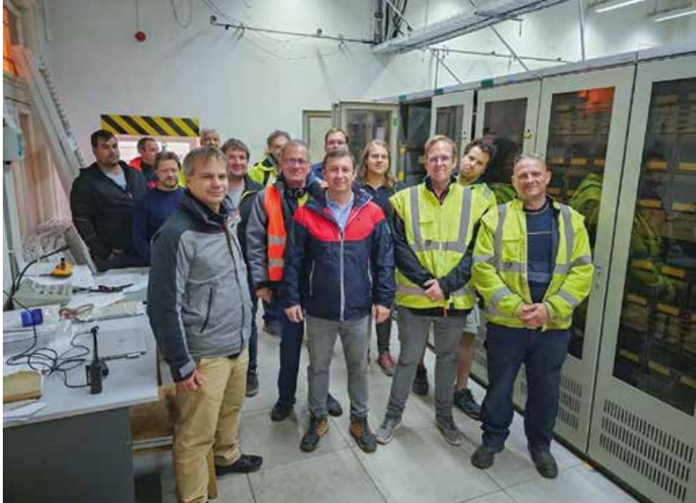
15. ábra: Tata állomás SIMIS C berendezésének kikapcsolása
