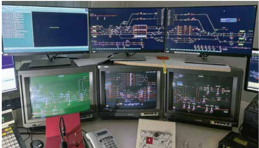
1. ábra: Hegyeshalom állomás ELEKTRA1 biztosítóberendezésének VC kezelőfelülete (alsó monitorsor) és az új ELEKTRA2 kezelőfelülete (felső monitorsor)
